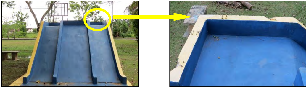
Taman Lengkuas - Safety Railing pada Concrete Slide Hilang (05.04.2017)
