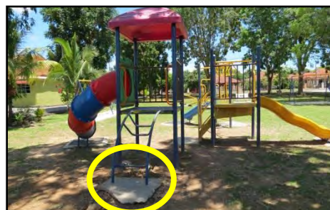
Taman Sri Indah Fasa 4 - Kerosakan Concrete Slab (06.04.2017)
