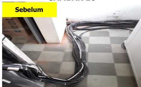
Bilik Kawalan Audio - Kabel Audio Alat Pembesar Suara Tidak Dipasang Menggunakan Penutup (16.01.2019) (Sumber: Jabatan Audit Negara)
