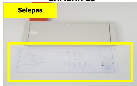
Bilik Kawalan, Bilik Pengubah dan Bilik Switchgear
