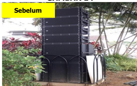
Alat Pembesar Suara No. 3 di Tebingan Kuching - Alat Pembesar Suara yang Dipasang Tiada Perlindungan Keselamatan Mencukupi (16.01.2019) (Sumber: Jabatan Audit Negara)
