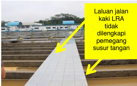
LRA Batu Kitang No. 3 - Laluan Jalan Kaki LRA Tidak Dilengkapi Pemegang Susur Tangan (09.01.2019) (Sumber: Jabatan Audit Negara)
