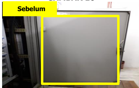
Bilik Kawalan, Bilik Pengubah dan Bilik Switchgear
