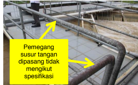
LRA Batu Kitang No. 3 - Pemegang Susur Tangan Berjenis Besi Galvani Tidak Mengikut Spesifikasi Kontrak (09.01.2019) (Sumber: Jabatan Audit Negara)
