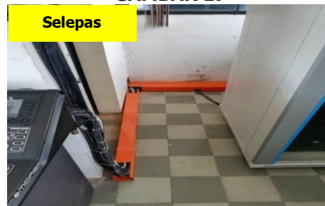
Bilik Kawalan Audio - Kabel Audio Alat Pembesar Suara Telah Dipasang Menggunakan Penutup (18.04.2019) (Sumber: Jabatan Audit Negara)
