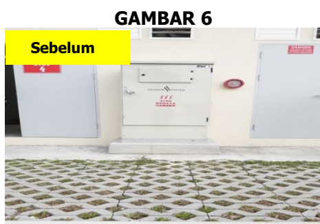
Bilik Papan Suis Utama - Kotak Pembumian Tidak Dipasang (16.01.2019) (Sumber: Jabatan Audit Negara)
