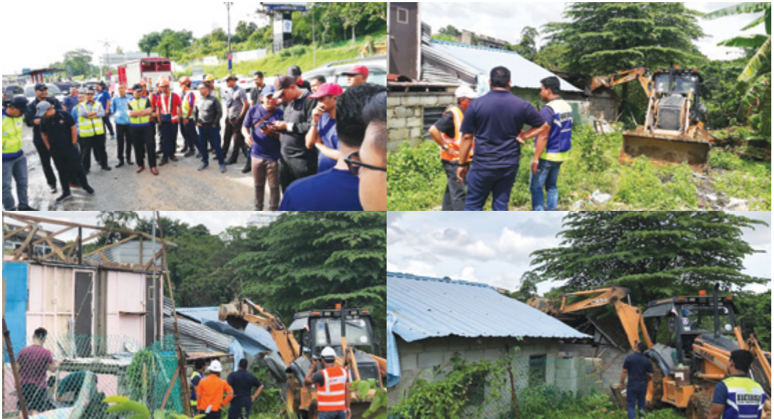
Gambar 17: Tindakan penguatkuasaan bagi tujuan Projek Landasan Berkembar Elektrik (PLBE) Gemas – Johor Bahru
