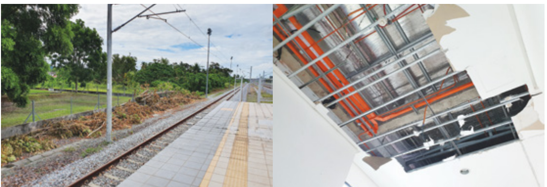
Gambar 24: Keadaan Stesen Keretapi Gurun di Kedah yang terjejas akibat kejadian ribut dan angin kencang pada Ogos 2019
